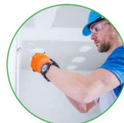
Instalación y puesta en marcha
